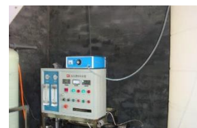
Zentrale Warmwasseraufbereitungsanlage der Rothlin Primarschule (bei Nanpi, Hebei Provinz)
